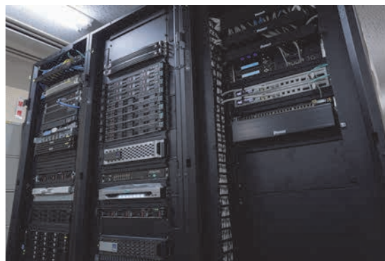
図 1 System11 サーバラック
